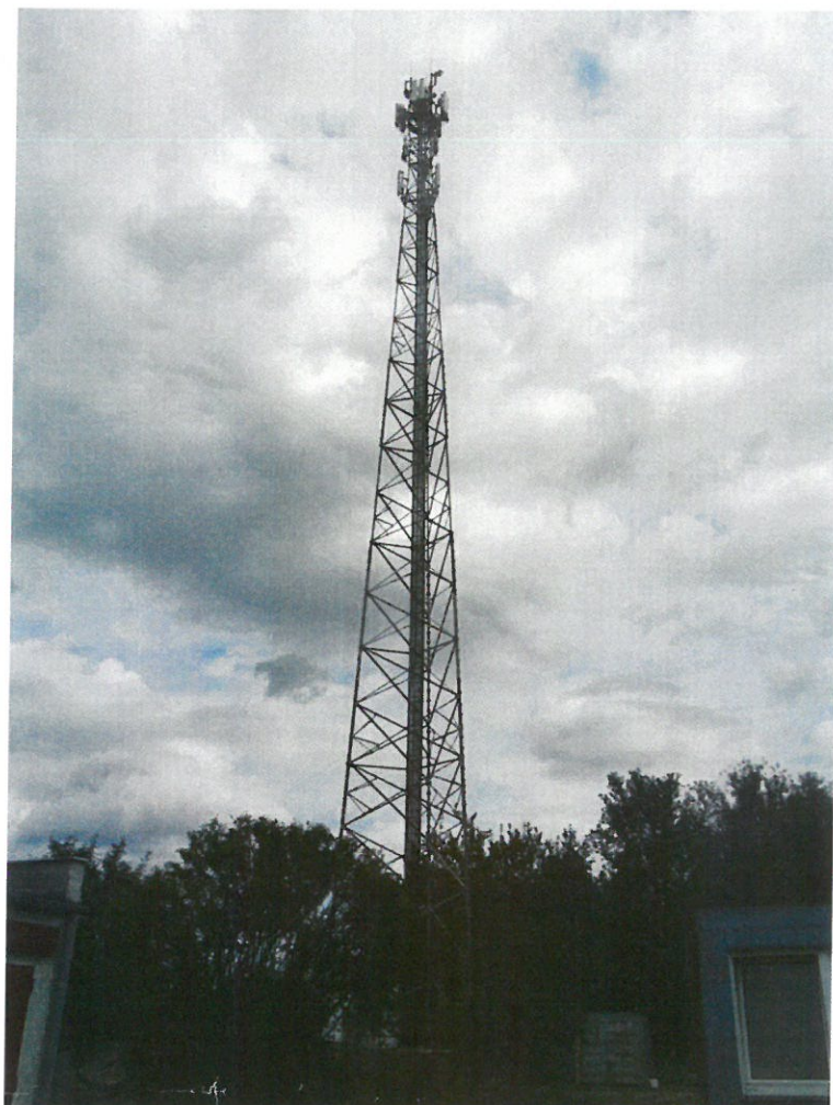
Zał. nr 1: Widok ogólny instalacji radiokomunikacyjnej.
