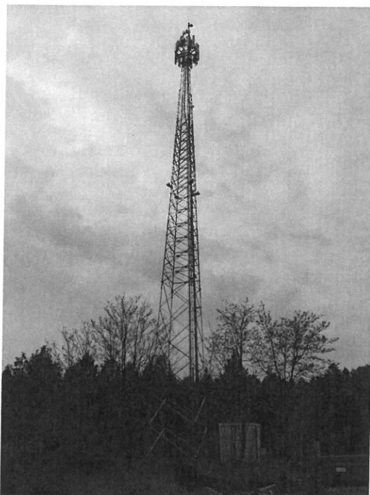
Zał. nr 1: Widok ogólny instalacji radiokomunikacyjnej.
