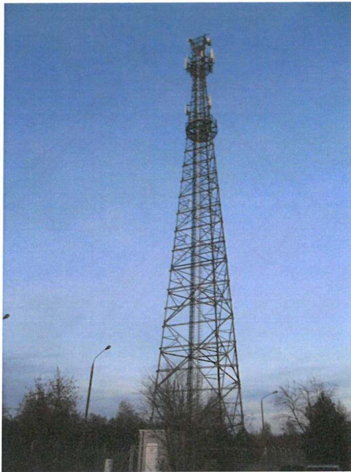
Zał. nr 1: Widok ogólny instalacji radiokomunikacyjnej.
